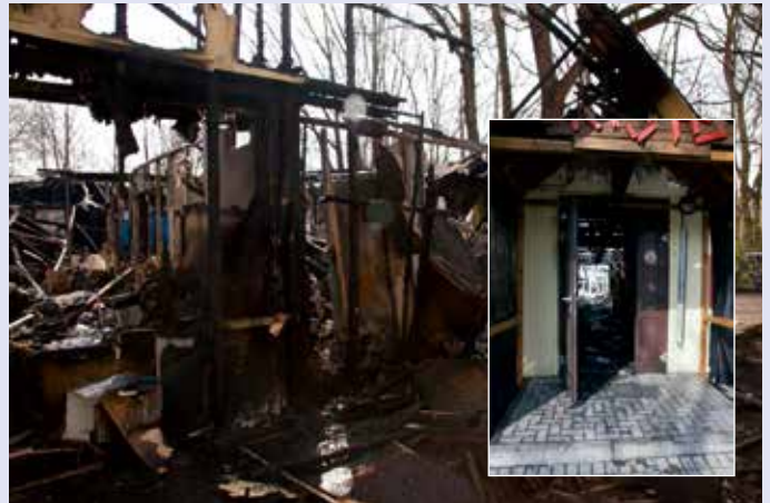
Der Holzbau wurde bei dem durch einen technische Defekt verursachte Brand völlig zerstört. Kleines Foto: Der Eingangsbereich nach dem Brand. Fotos: Sarah Koßmann
